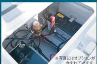
22 バッテリールーム
