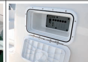
ブレーカーパネル
